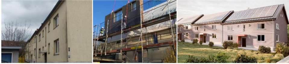
Serielle Sanierung von drei Wohnhäusern aus den 1930er-Jahren in Hameln mit vorgefertigten Elementen. Die Installation eines Dämmelements dauerte lediglich 20 Minuten. © ecoworks
